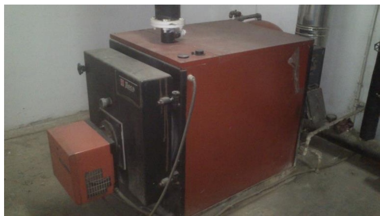
Caldera de agua caliente Colegio Antonio Machado.
