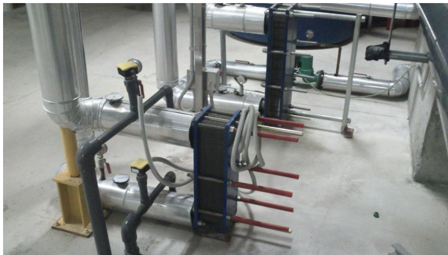
Inventario de intercambiadores de calor.
