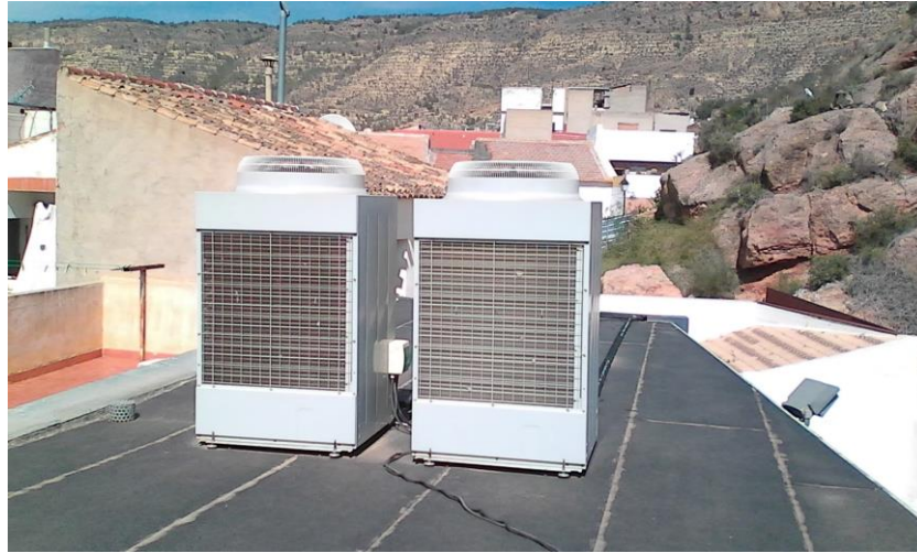
Unidades exteriores de climatización.
