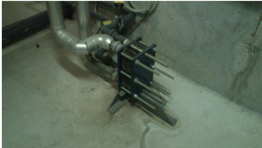
Intercambiador de calor de la piscina pequeña.
