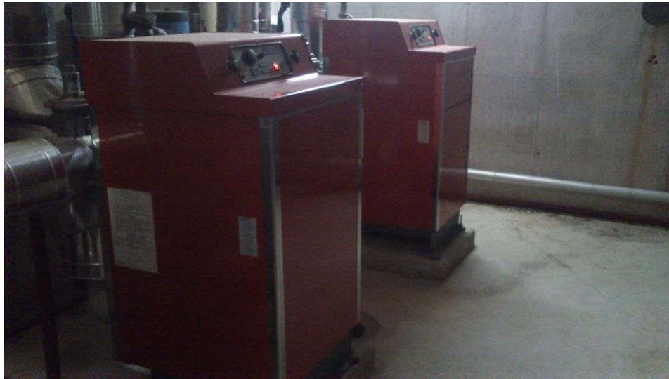
Calderas ADISA piscina climatizada.
