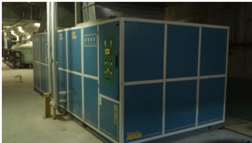
Deshumectadora piscina climatizada.
