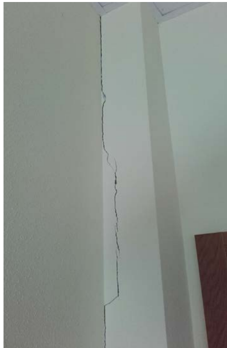
Ilustración 18: Grieta presente en el interior del edificio de control
