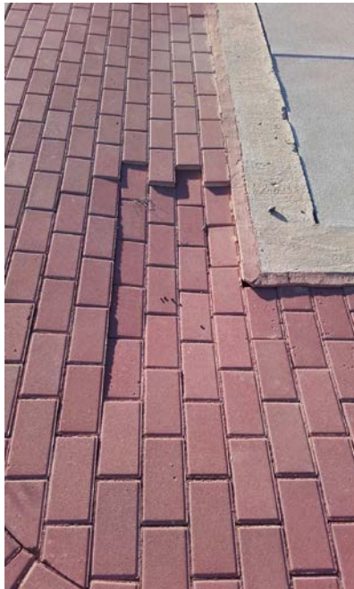
Ilustración 16: Hundimientos en accesos adoquinados de la instalación
