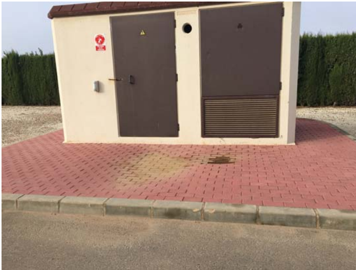
Ejemplo de pavimento hundido en la EDAR.
