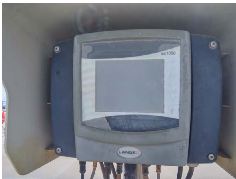
Ilustración 8: Controlador Hach-Lange SC1000 instalado en la EDAR, totalmente dañado por las condiciones meteorológicas
