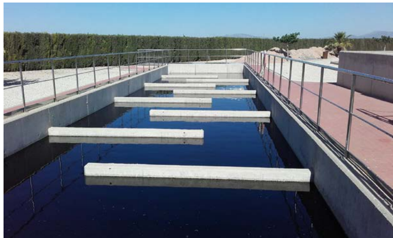
Ilustración 2: Laberinto de cloración de la EDAR Condado Alhama
