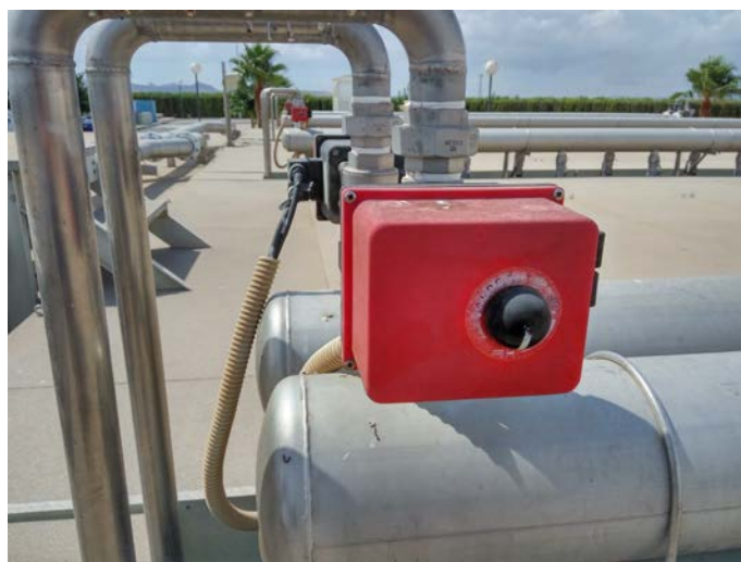
Ilustración 9: Actuador eléctrico Valpes ER35/ER60 existente en la EDAR, fuera de servicio.
