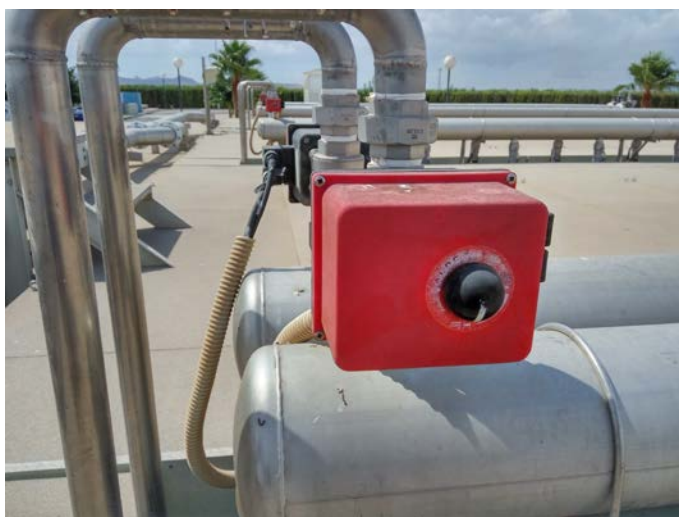
Ilustración 9: Actuador eléctrico Valpes ER35/ER60 existente en la EDAR, fuera de servicio.
