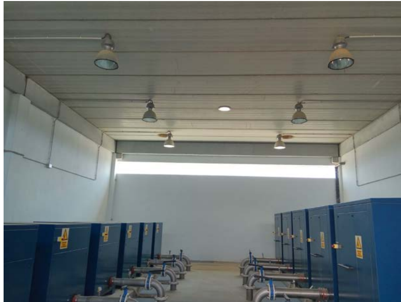
Ilustración 13: Sala de soplantes de la EDAR Condado de Alhama
