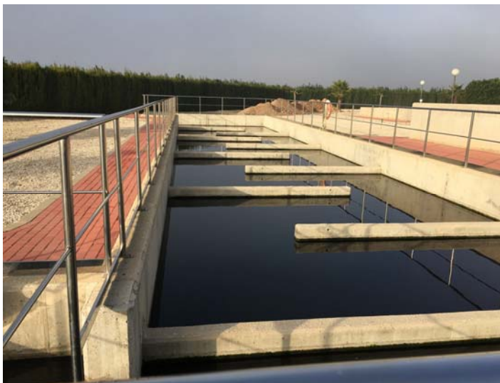
Laberinto de cloración de la EDAR.
