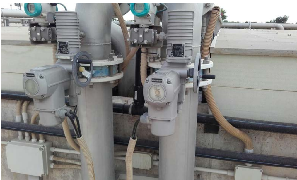
Ilustración 10: Actuador eléctrico Auma, instalado en la EDAR fuera de servicio debido a la falta de mantenimiento
