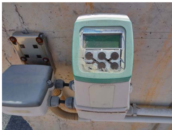
Ilustración 5: Display caudalímetro Siemens MAG6000 instalado en la EDAR.
