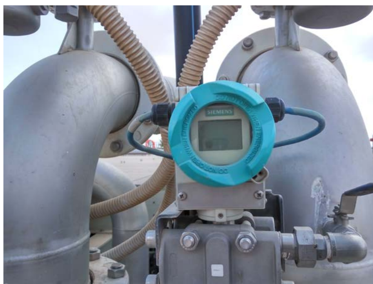
Ilustración 6: Imagen del medidos de presión instalado.
