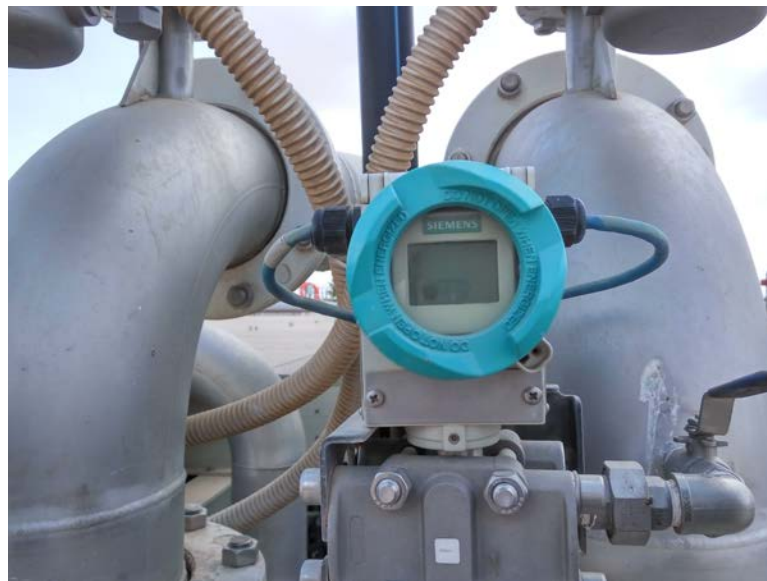
Ilustración 6: Imagen del medidos de presión instalado.
