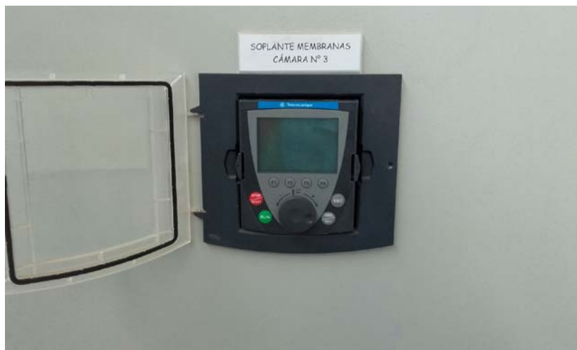
Ilustración 7: Pantalla de control Telemecanique ATV71 averiada en uno de los variadores del CCM de la instalación
